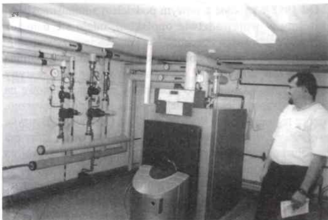
Kotłownia w szkole w Żytniowie ...
